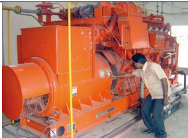
Gas-fired gen set supplying power to the feedmill เครื่องปั่นไฟใช้ก๊าซธรรมชาติ ผลิตไฟฟ้าป้อนโรงงานอาหารสัตว์
